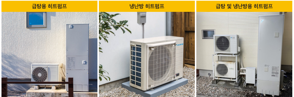
그림-6 일본의 냉난방 및 급탕 히트펌프 설치 사례
