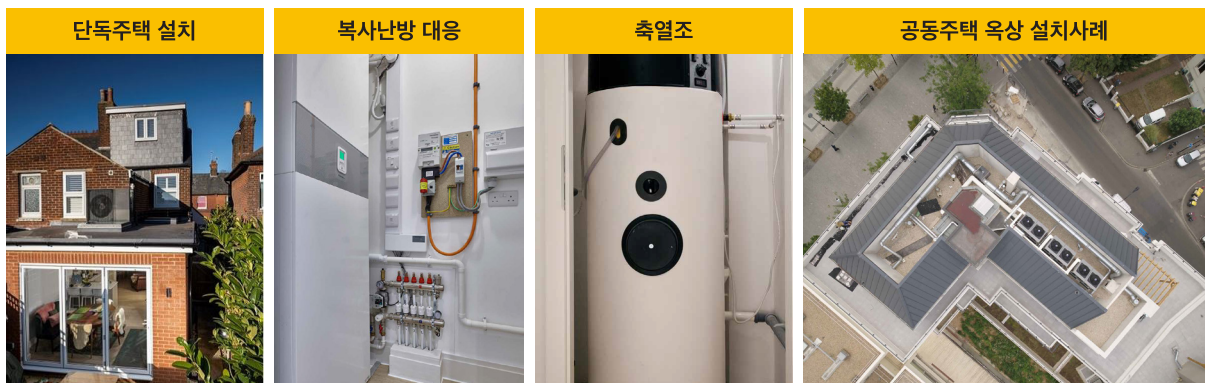
그림-5 유럽의 복사난방 방식 이용 히트펌프 설치 및 공동주택 설치 사례
