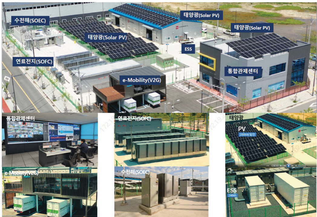
[그림 4-2] 창원그린에너지센터 전경 및 에너지자급자족형 인프라 구성 사진
