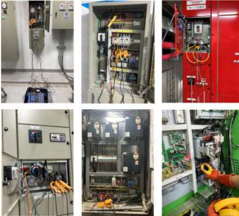
[그림 4-1] 전력분석기 설치 예시
