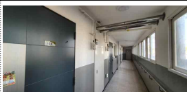
복도에 설치된 안전손잡이
