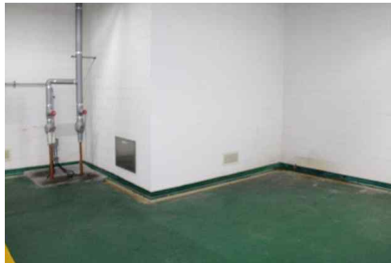
[전기실 장비 반입구 외벽 균열누수]
