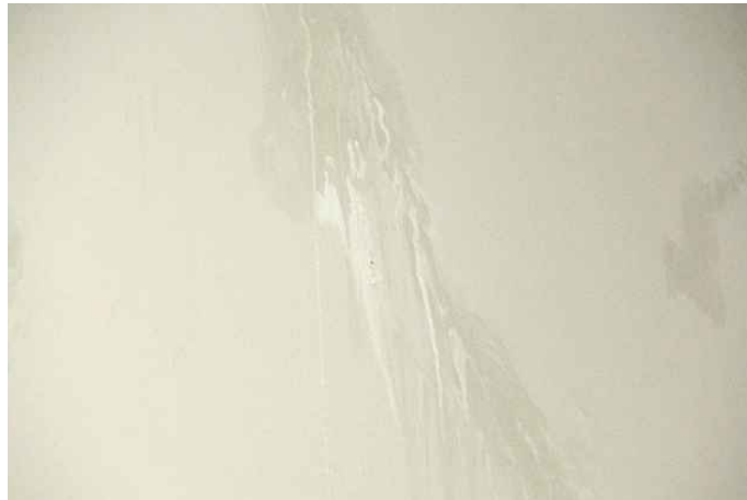
전기실 내부 벽체 균열누수
