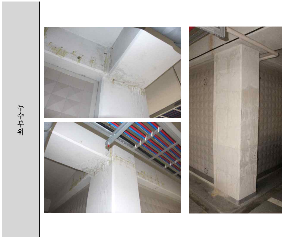
[그림 I-6] 외벽 보-기둥 연결부 균열누수
