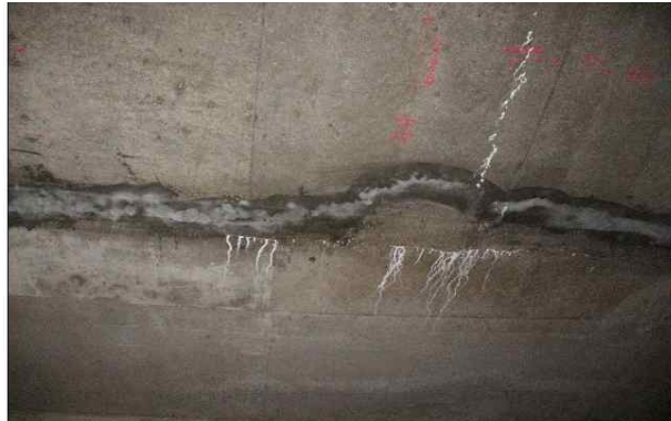
전기실 내부 벽체 균열누수
