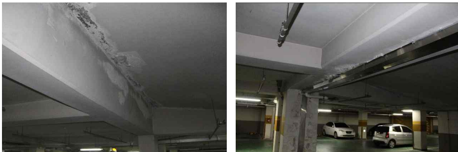
[그림 D-1] E/J 조인트 누수부위 및 유도배수공법 보수조치
