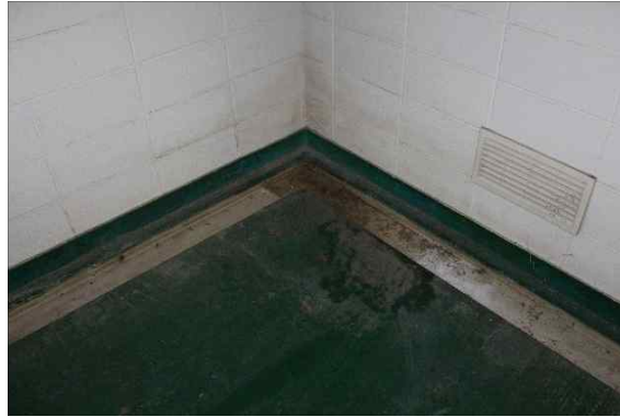
[전기실 장비 반입구 외벽 균열누수]
