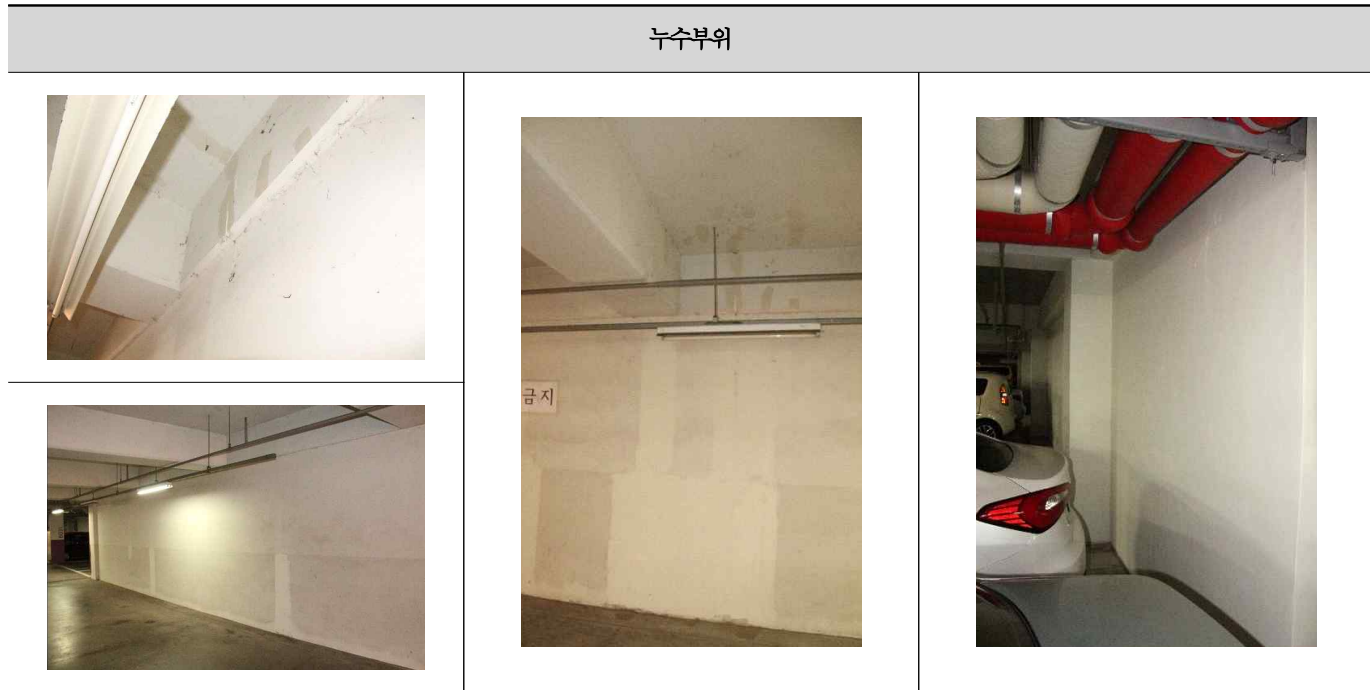
[그림 G-7] 외벽방향 슬래브-보 연결부 누수부위(사인장 균열, 수직균열 및 누수발생)
