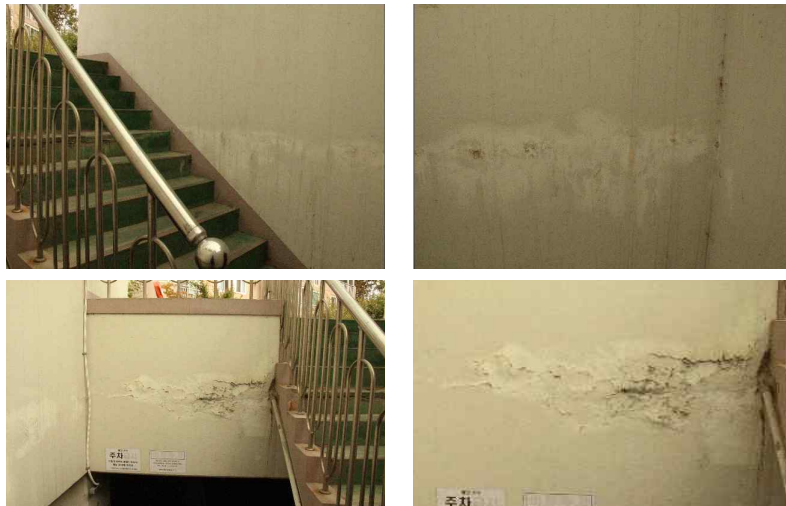
[그림 C-1] 계단실 내부 시공조인트 누수로 인한 백화 및 페인트 박락
