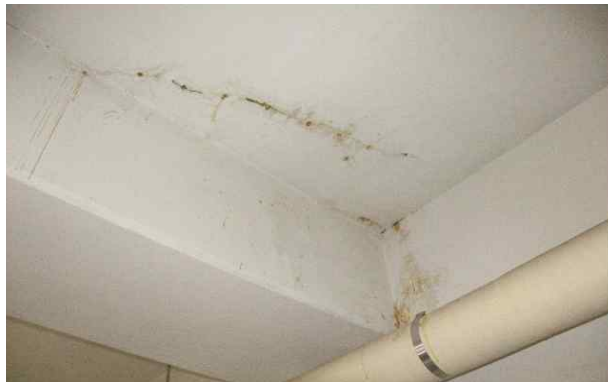
외벽방향 슬래브-보-기둥 연결부 균열누수
