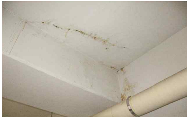
외벽방향 슬래브-보-기둥 연결부 균열누수
