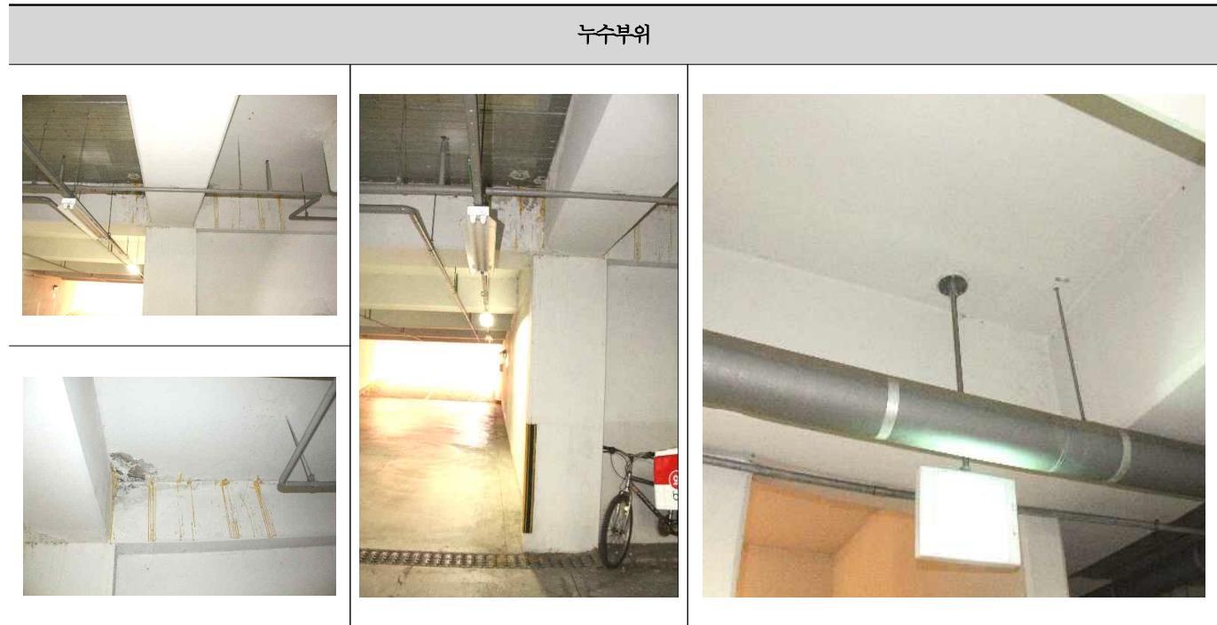
[그림 G-5] 외벽방향 슬래브-보-기둥 연결부 누수부위
