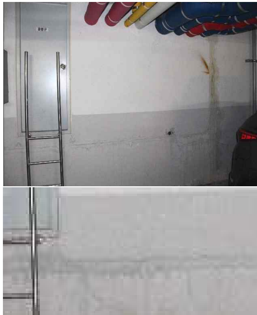
공동구-외벽 시공조인트 누수
