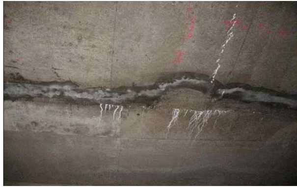
전기실 내부 벽체 균열누수
